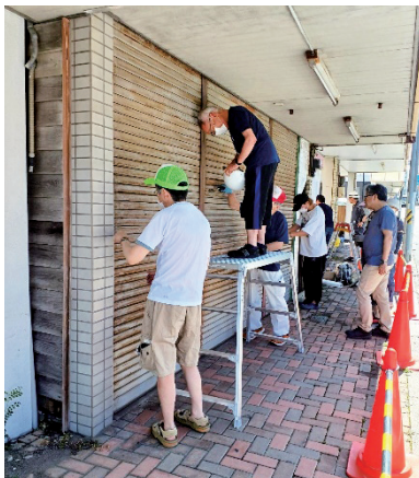
写真9 住民による錆取り
